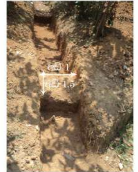
තද වර්ෂාවකදී පිටාර නොයන ලෙස ප්‍රධාන කාණුවෙන් දෙපසට අඩි 10න් 10ට කුට්ටි සහිතව සමෝච්ච කාණු දැමීම
